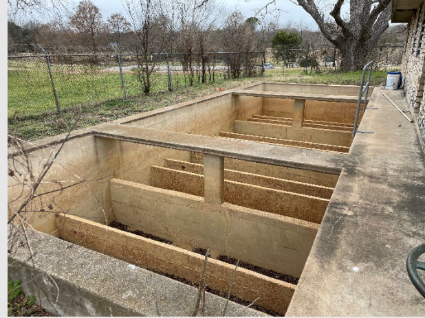
Filtration System Sistema de filtración
